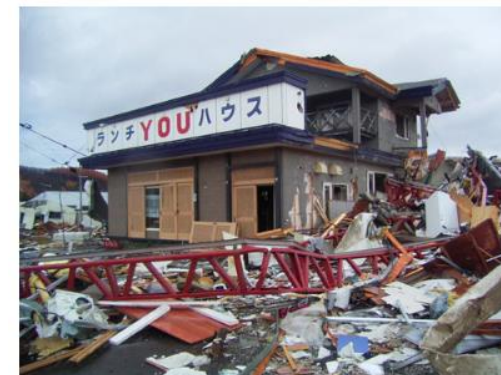
写真20 飛来物による損傷の激しい店舗併用住宅 (国土交通省北海道開発局提供)
