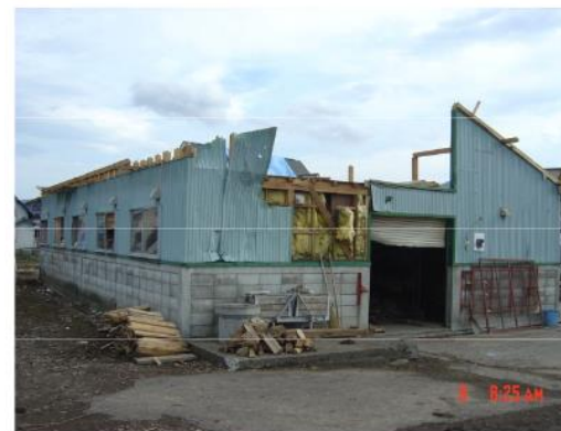
写真26 屋根が飛ばされた倉庫
