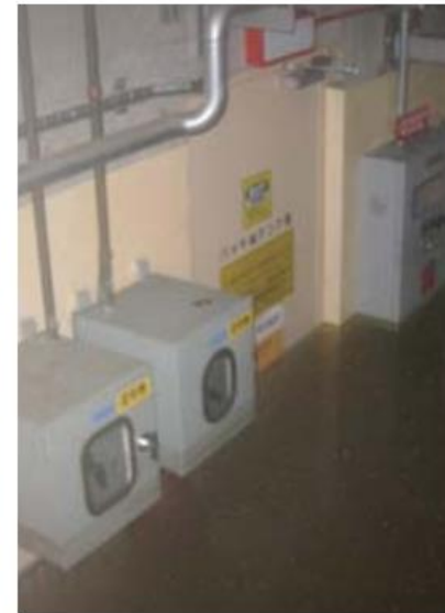
水没した電源室 (福島第一原子力発電所2号機)
